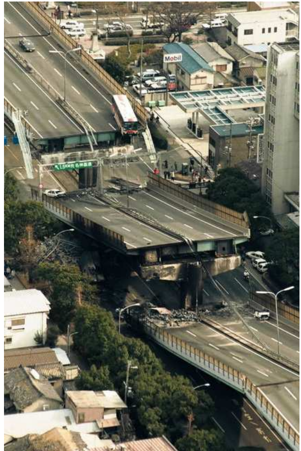
橋げたが落ちた阪神高速 西宮市本町付近
